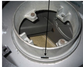
So sieht der fertige Kondensatablauf
